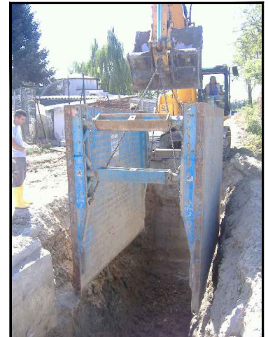
Foto 5 - Posa armatura per scavo a sezione obbligatoria di profondità oltre i 2 m.
