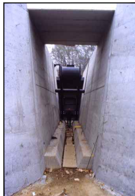
Ventola di modulazione del deflusso
