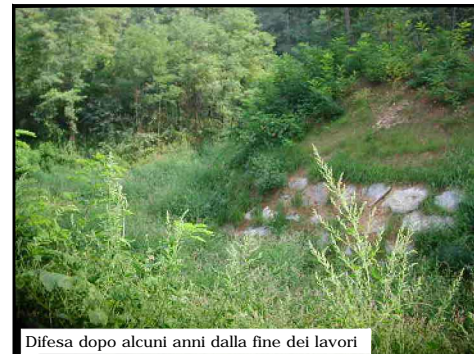
Difesa dopo alcuni anni dalla fine dei lavori
